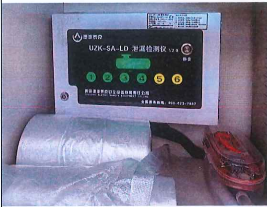
储罐渗漏监测
