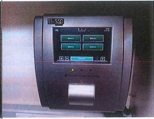
双层油管渗漏监测
