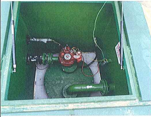
柴油罐操作井
