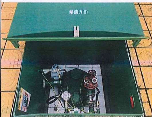
柴油罐操作井
