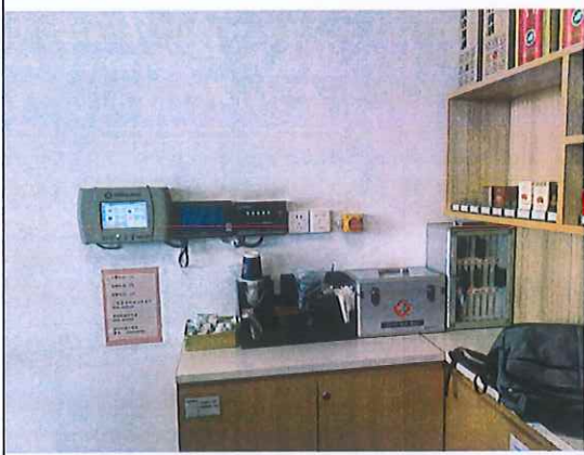
液位计、油罐油管在线渗漏监测系统 紧急切断按钮
