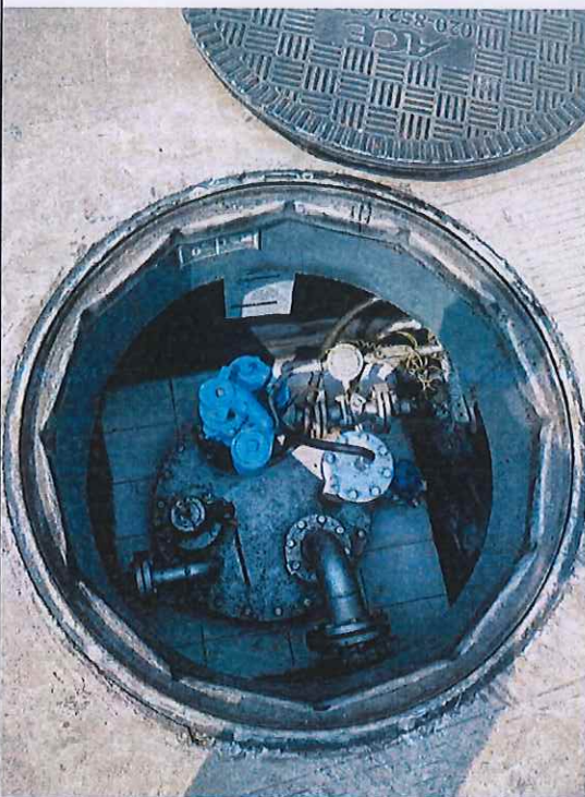
柴油罐操作井
