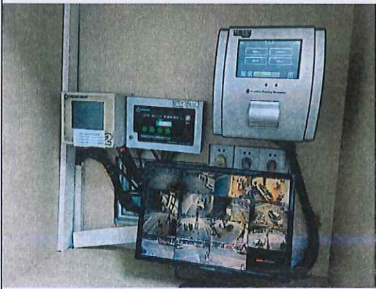
油罐在线泄漏监测系统、液位计、视频监控
