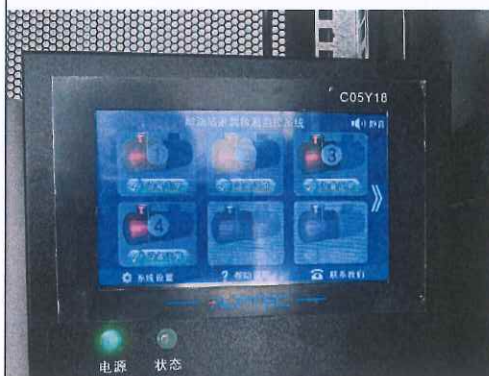
油罐在线渗漏监测系统
