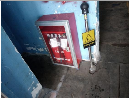
灭火器及静电消除器
