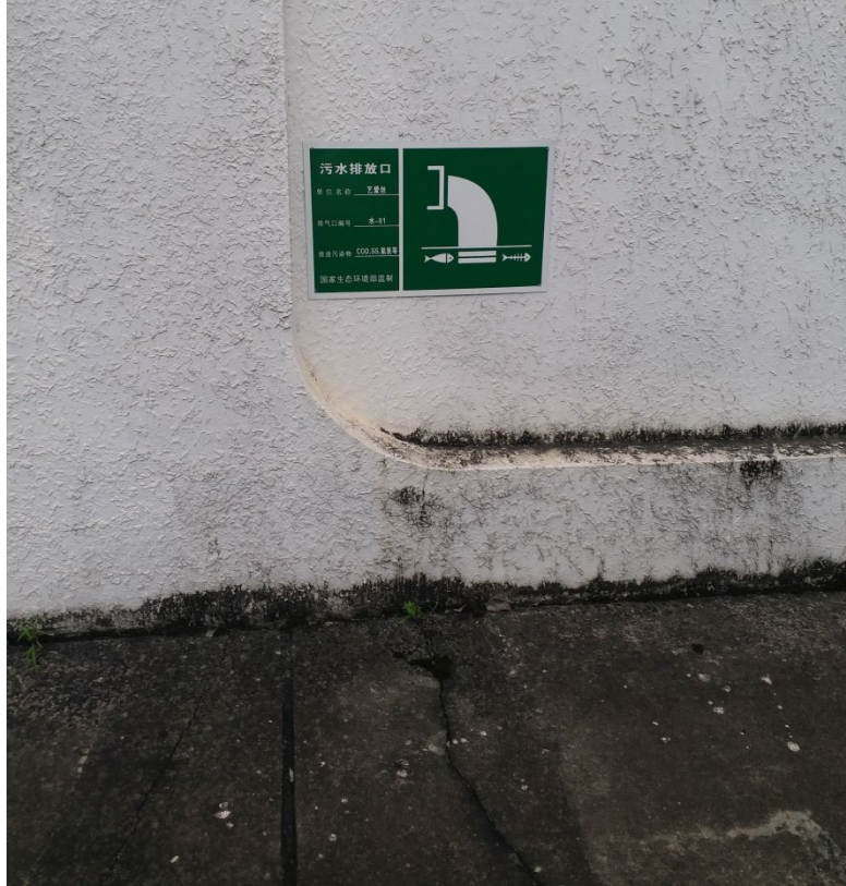
MVR 蒸发系统废水排放口
