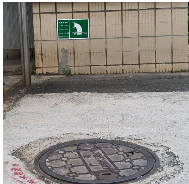
生活废水排放口
