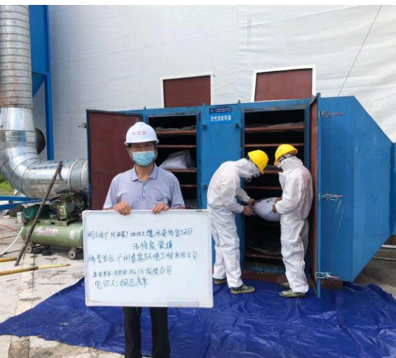
尾气处理设备活性炭装填
