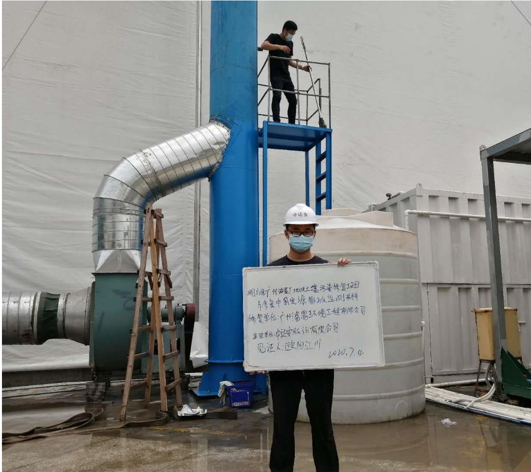
图2.4-3 尾气处理设备大气排放点监测监理旁站
