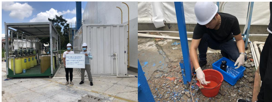
图 2.4-4 场内污水处理设施及检测照片
