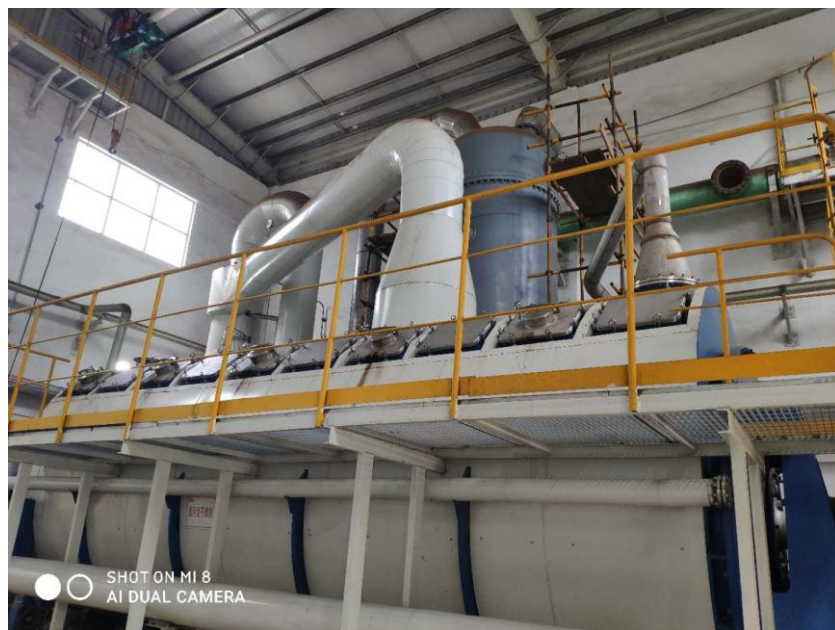
图 1 除尘+冷凝装置
