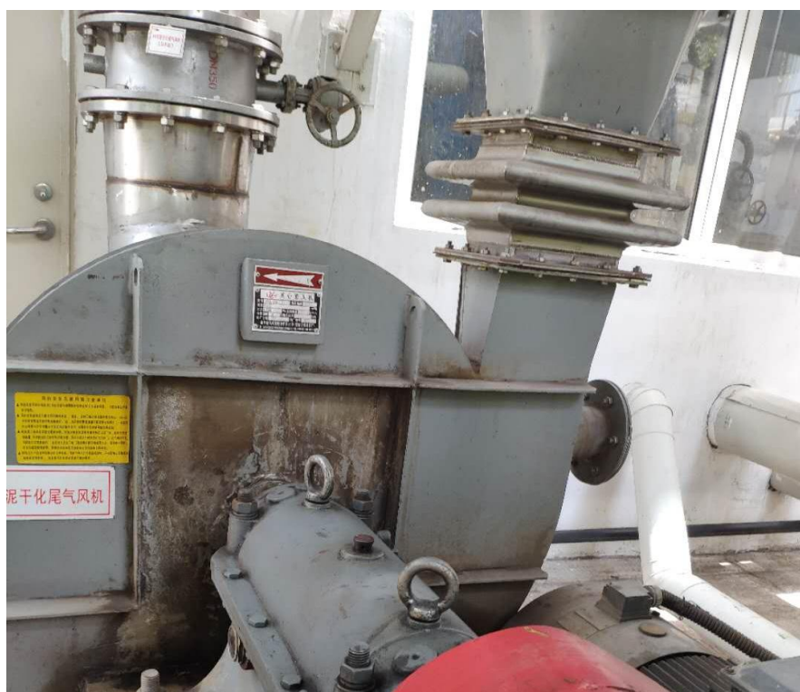
图 2 污泥干化尾气风机
